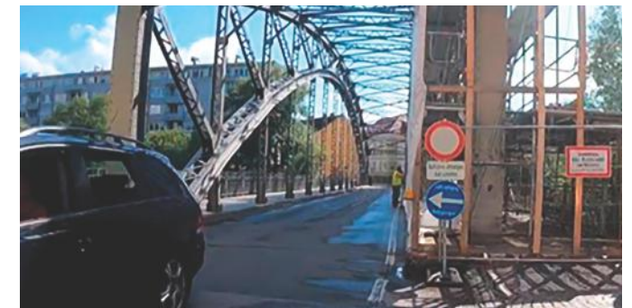
16. ábra: Nem megfelelő forgalmi jelzések egy építkezésnél, biztonságos kerülő út nélkül az EuroVelo 14 ausztriai szakaszán
